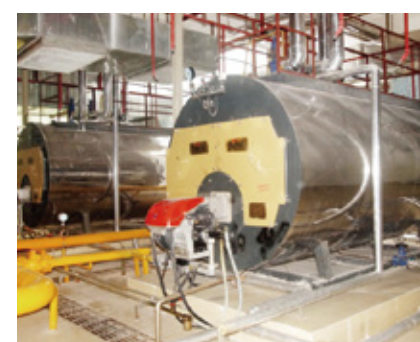
改造前 3台 3t/h，两用一备 占地约 320 m 2
